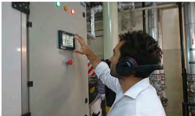
Configuracion de PLC
